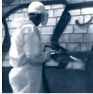
Das Niederdruck- Feuchtstrahlssystem.
