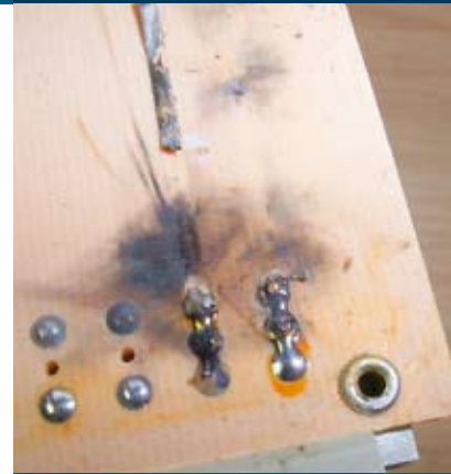
Deutlicher Überspannungsschaden am Netzeingang einer Heizungssteuerung.
