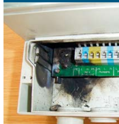
Massive Rauch- und Schmauchspuren, die auf einen direkten Überspannungsschaden hinweisen.
